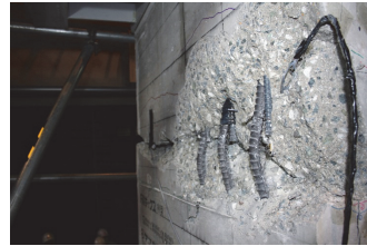
写真-3 主鉄筋の座屈状況
